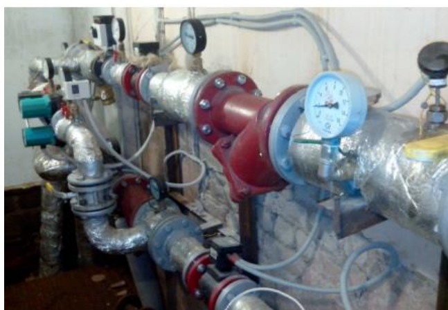
Рисунок 1. Общий вид автоматизированного теплового пункта
